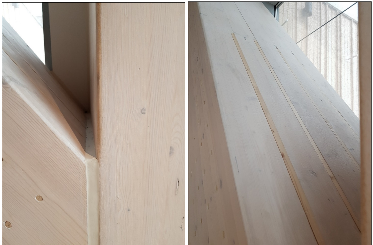
Figure 16 : Les joints dans lesquels les bandes intumescentes sont insérées sont fermés soit par un mastic synthétique soit par des planchettes en bois
